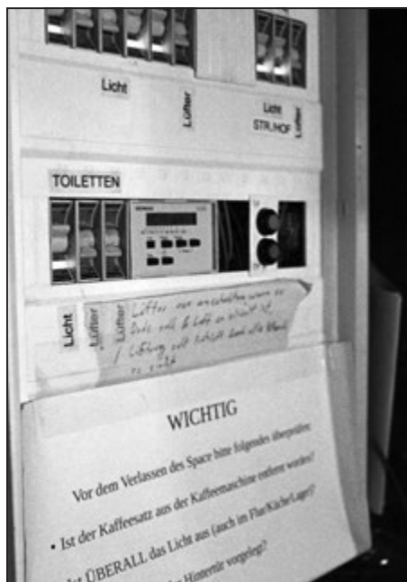
Sicherungskasten im Hackerspace
